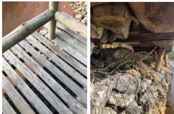
Figura 3 – Condições estruturais do porto de regência
