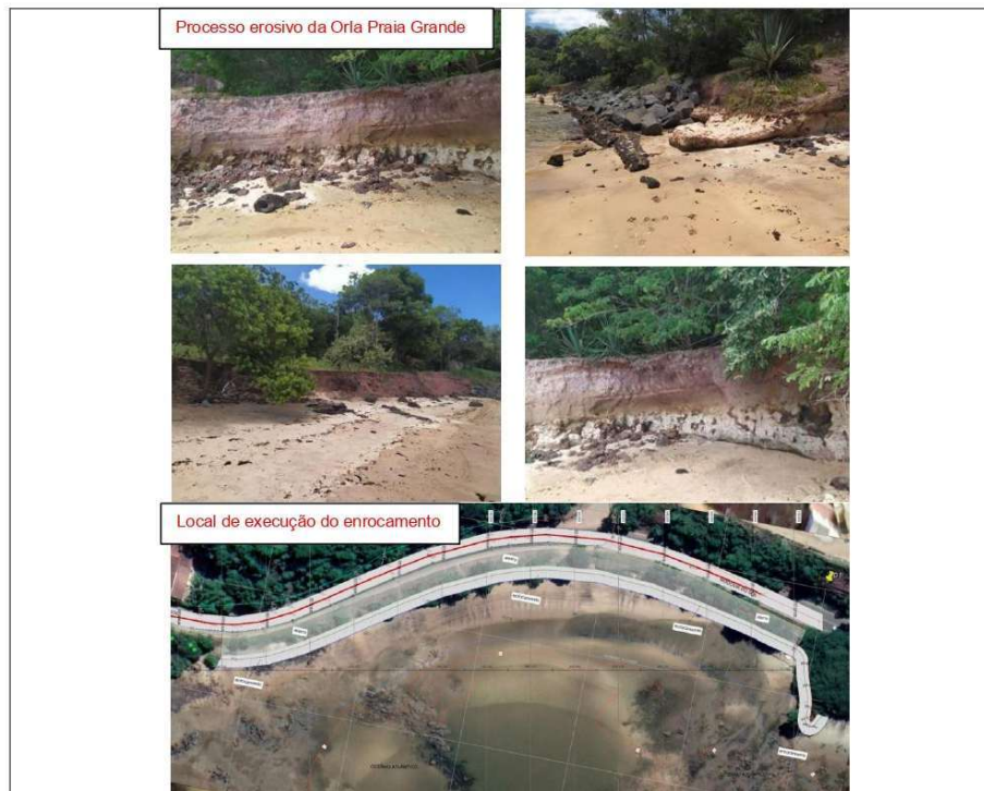
Figura 3 – Registro fotográfico do grau de erosão no trecho em que está previsto o enrocamento
